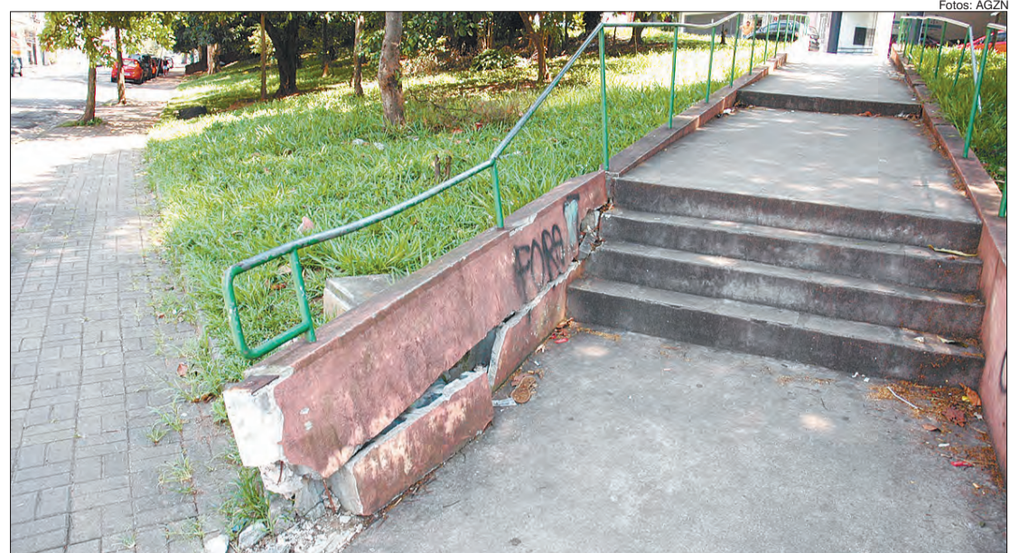
Escadaria entre as ruas Ararituaba e Mere Amédea precisa de reparos
