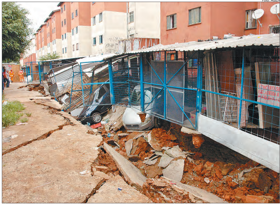
Cratera de aproximadamente 30 metros se abre no Conjunto Habitacional Cingapura
