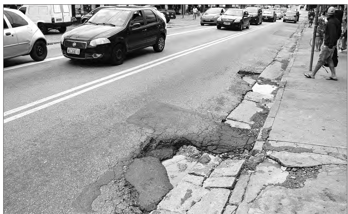
Rua Zilda, na Casa Verde, tem vários buracos na pista
