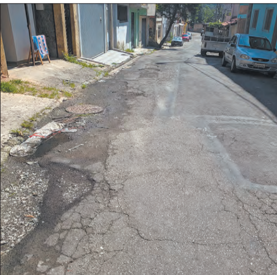
A extensão da Rua Serrana é cheia de buracos
