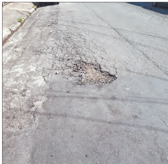
Buraco na Rua Clóvis Salgado
