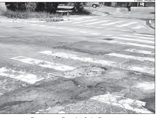
Buraco na Rua Antônio Borges
