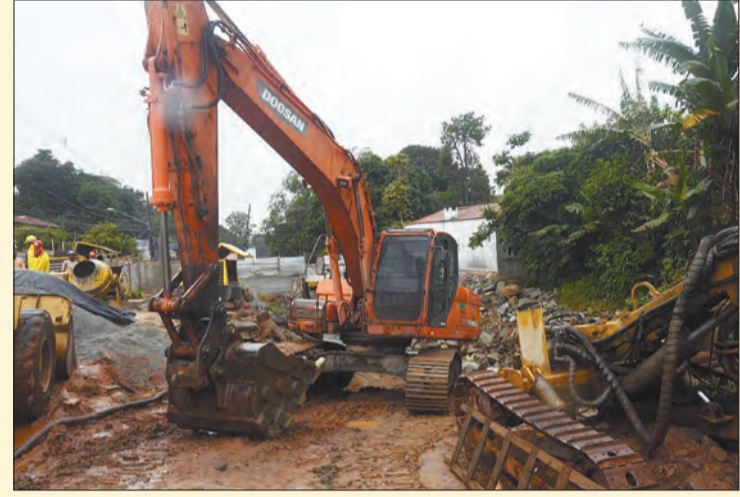
Trecho do Córrego Tremembé em obras na Avenida Maria Amália Lopes de Azevedo
