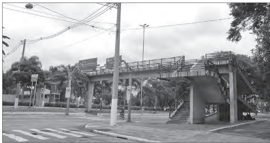
Manutenção das passarelas danificadas está entre as demandas apresentadas para a Prefeitura
