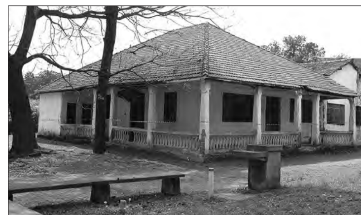
Edificações antigas permanecem sem manutenção e ainda podem ser vistas no parque
