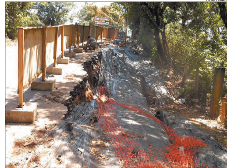
Avenida Sezefredo Fagundes, altura do nº 5.990, em obras por um período de 180 dias
