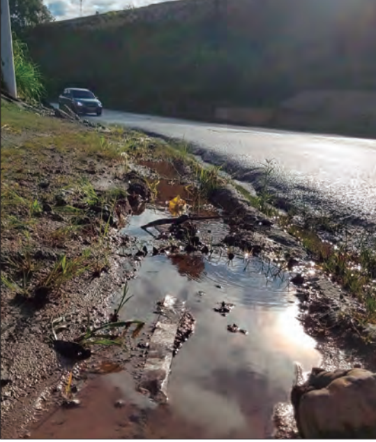
Vazamento na Avenida Cel. Sezefredo Fagundes, 15.800
