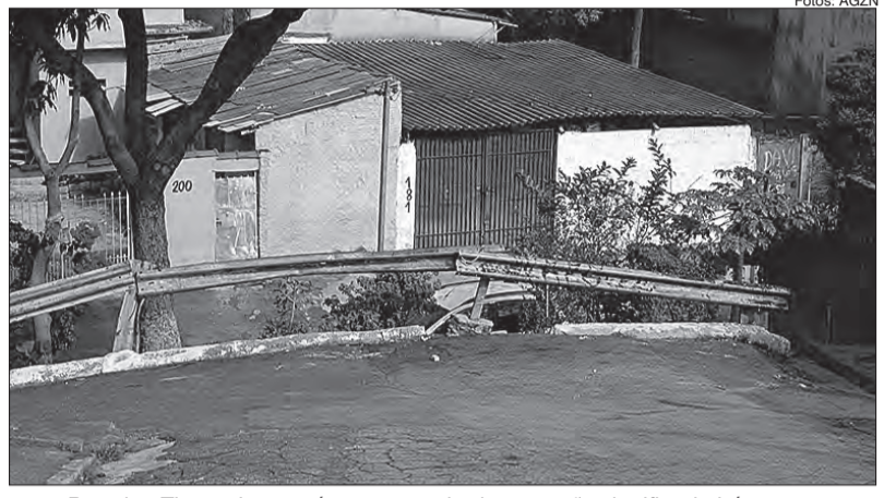
Rua dos Timoneiros está com a grade de proteção danificada há meses
