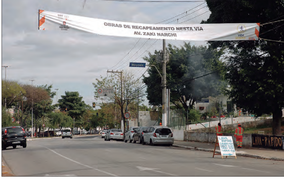
Avenida Zaki Narchi está com a pista fresada para obras de recapeamento
