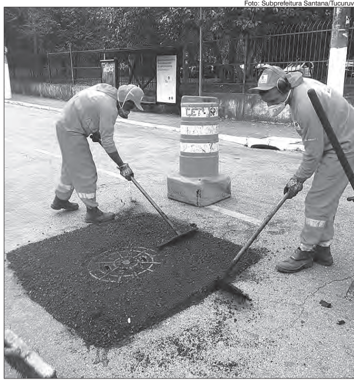
Buraco na Rua Augusto Tolle foi reparado na última quinta-feira (16)
