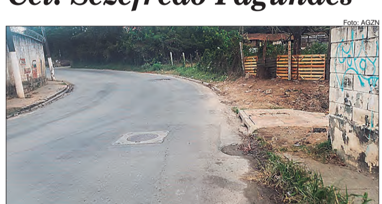
Vazamento recorrente foi consertado em 24/7
