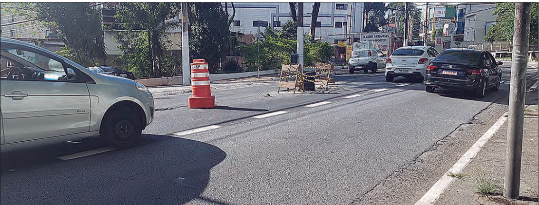
Trânsito intenso e cone sinalizando o buraco
