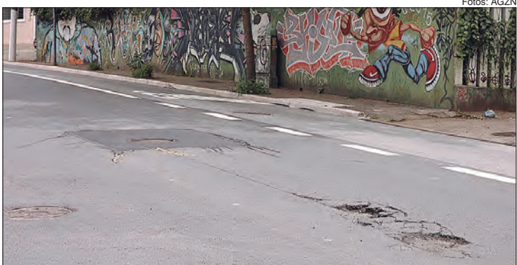
Buraco fechado pela Sabesp e em volta buraco no asfalto que foi recapeado recentemente
