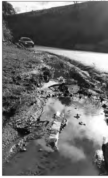
Um vazamento de água persistiu por vários meses na Avenida Cel. Sezefredo Fagundes, próximo ao número 15.800
