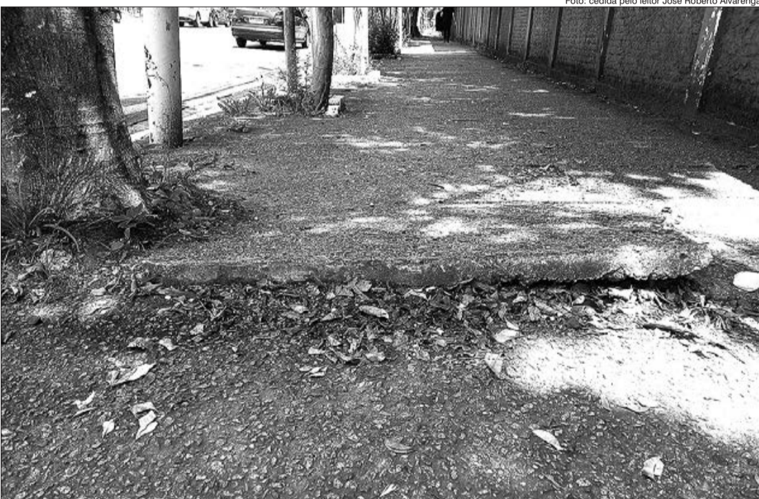
Calçada em desnível em trecho da Avenida Braz Leme
