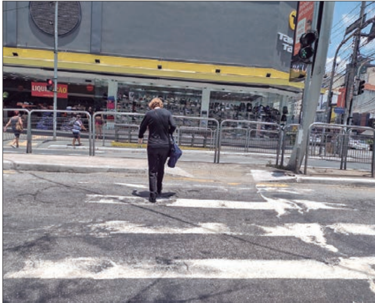
Travessia de pedestres é prejudicada com ondulação na pista na Rua Racionalismo Cristão
