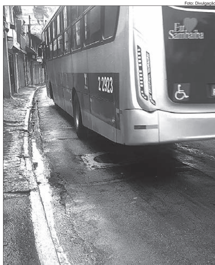
Rua Filhos da Terra apresenta afundamento e rachaduras na pista, relatam moradores
