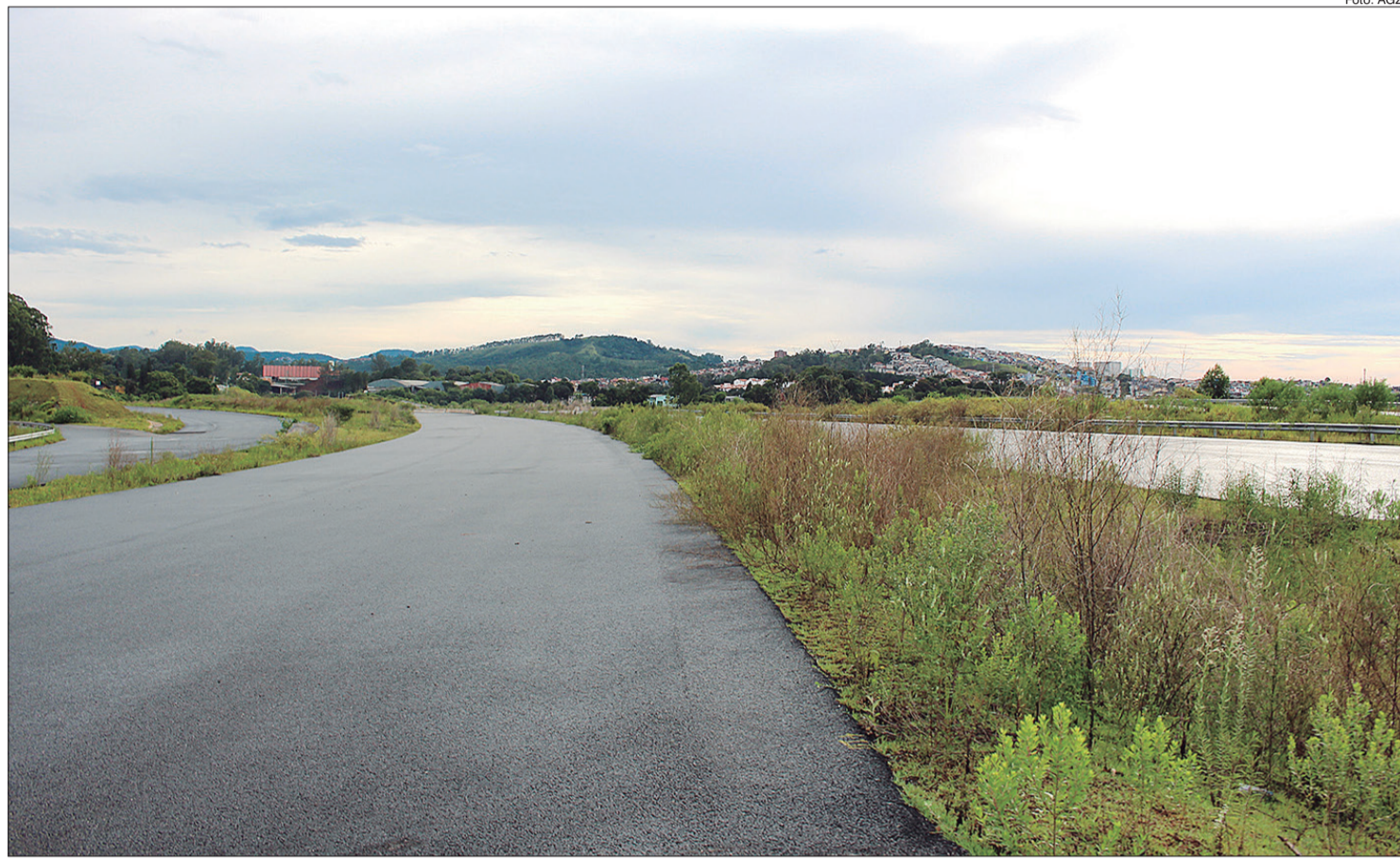
Pistas do Rodoanel Trecho Norte apresentam danos antes da conclusão da obra
