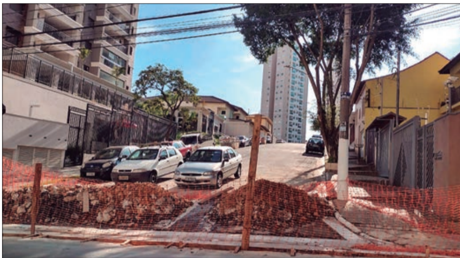
Rua Dom Antônio dos Santos Cabral também está com acesso fechado para obras
