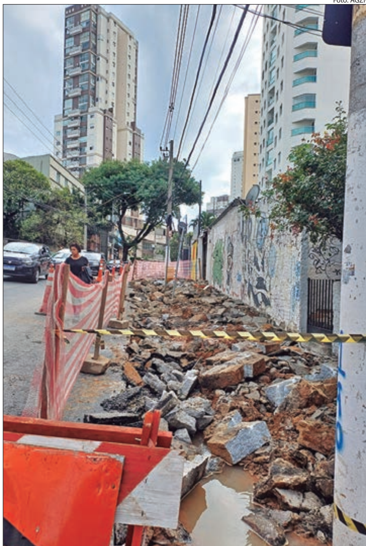
Obras começam na Alameda Afonso Schmidt e se estendem ao longo da Avenida Imirim
