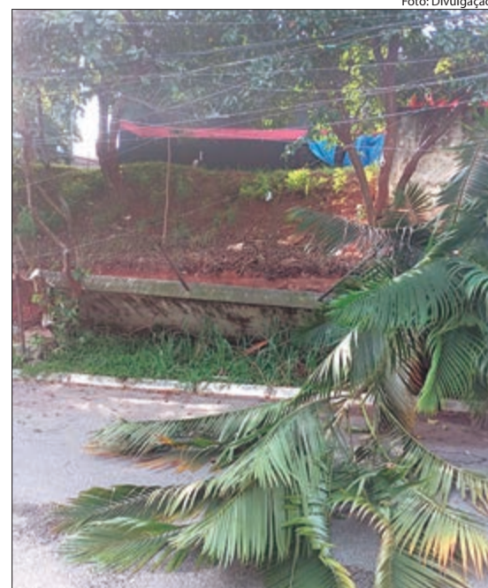
Foto encaminhada por moradores das proximidades, após queda do muro na madrugada do último domingo (26)
