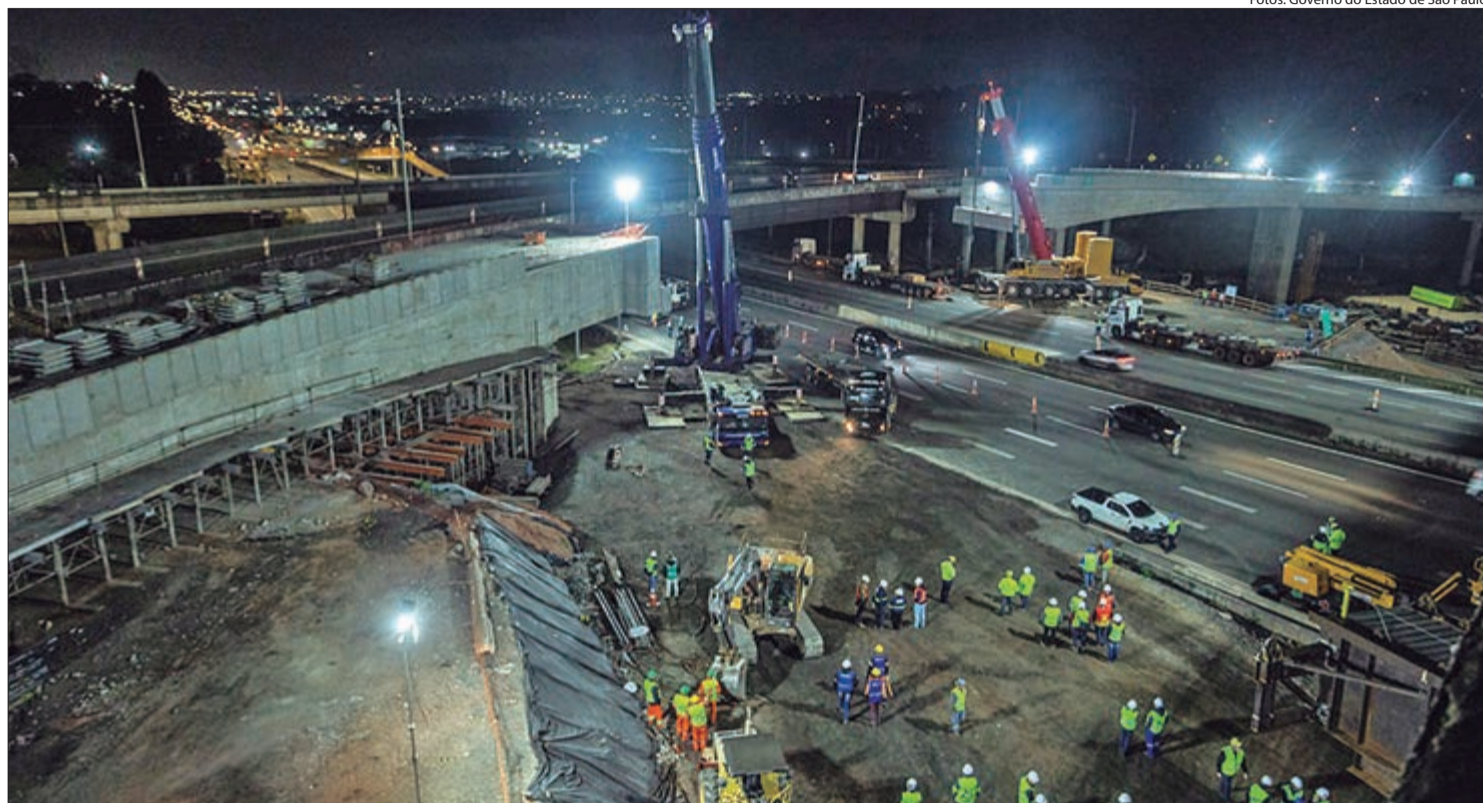
Rodoanel Norte recebe vigas metálicas para sustentar as alças de acesso do Rodoanel Norte à Rodovia Presidente Dutra
