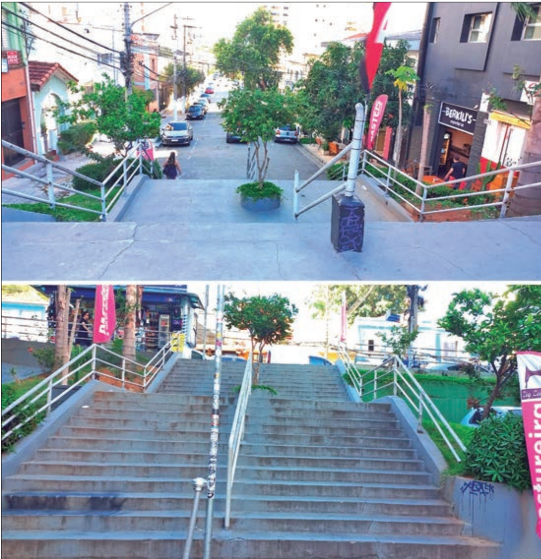
Escada da Rua Salete está com corrimão danificado
